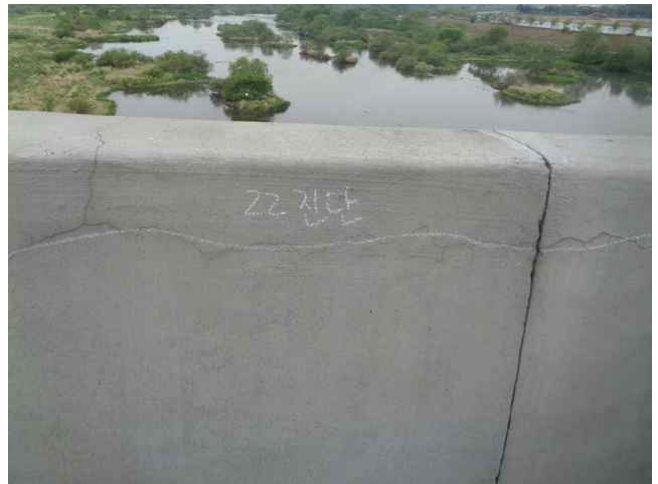
■ 부 재 : S6 ■ 손 상 : 방호벽 균열(폭 0.2mm)
