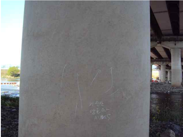
■ 부 재 : P6 ■ 손 상 : 기둥부 망상균열(폭 0.1mm)
