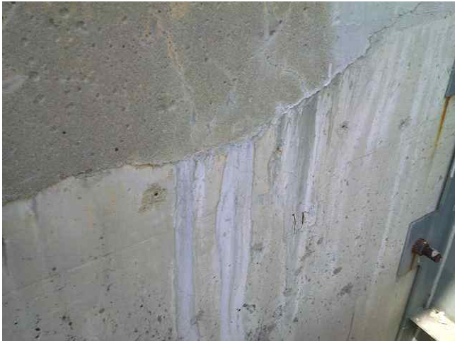
■ 부 재 : P7 ■ 손 상 : 코핑부 철근노출
